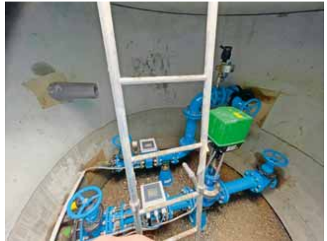
Installationen im neuen Verteilschacht
