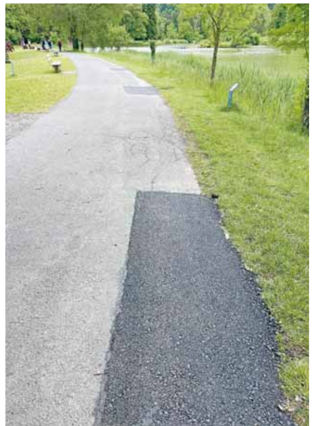
Giessenparkweg mit diversen Flickstellen
