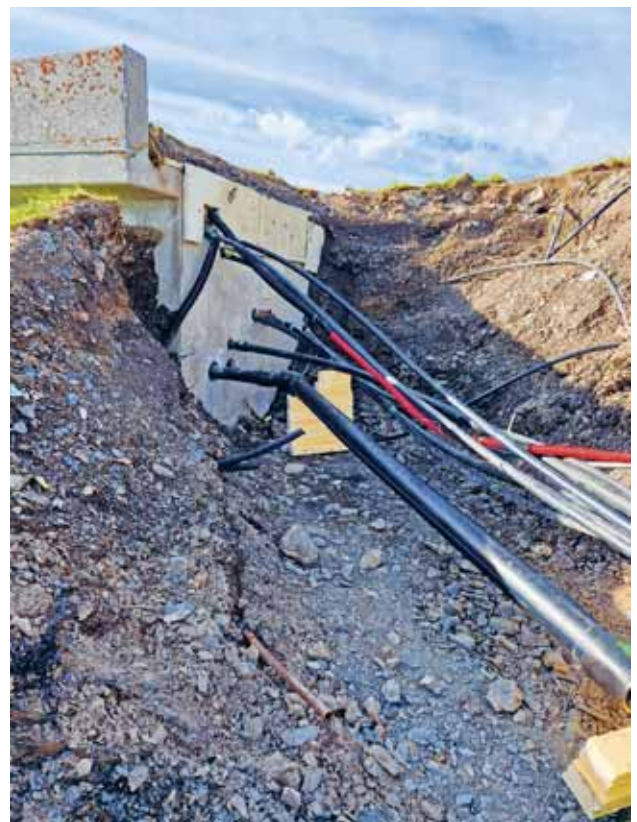
Neue Installationen beim Reservoir
