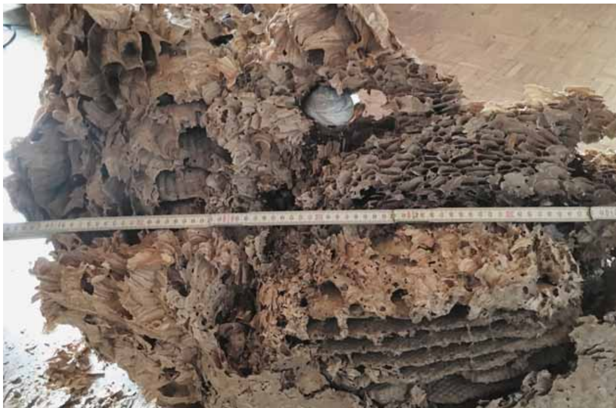
Hornussennest in der Fassadenisolation
