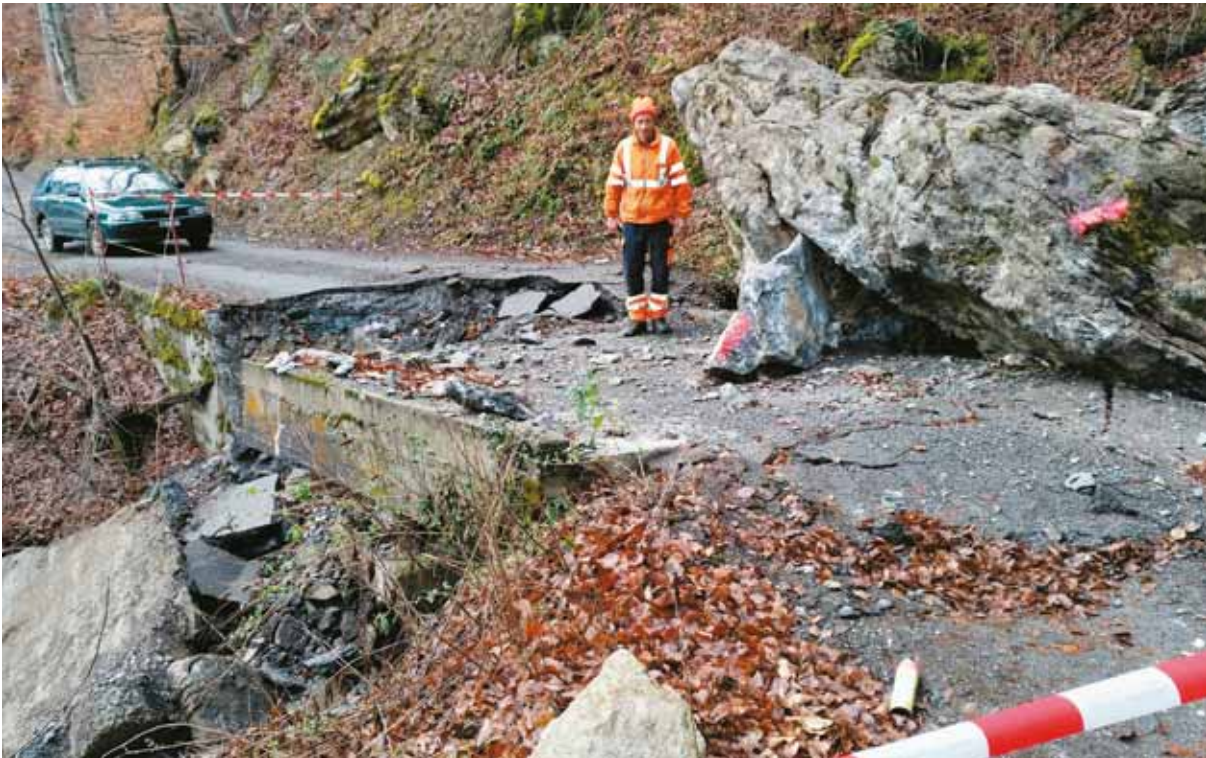
Steinschlag Zaschgabach (Alpstrasse nach Brintschingg-Zeiger)
