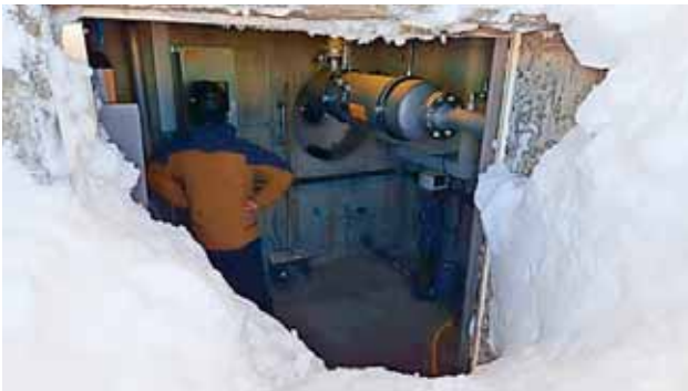
Freigeschaufeltes Reservoir Pizol mit UV-Anlage
